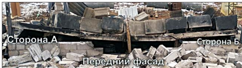
Рис. 6. Общий вид разрушенного фрагмента здания
